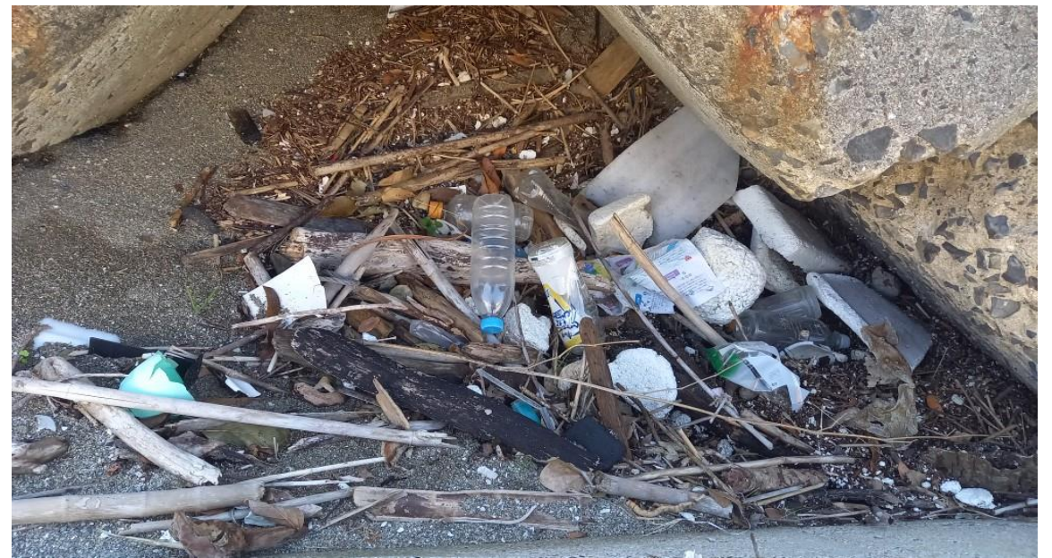
同左の消波ブロックの中 危険なためそのまま
